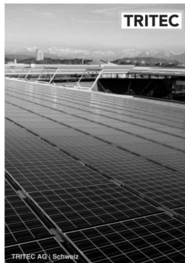
1.35 MWp Solarstromanlage Stade de Suisse Bern „Grösste Stadion-integrierte Photovoltaikanlage der Welt“
